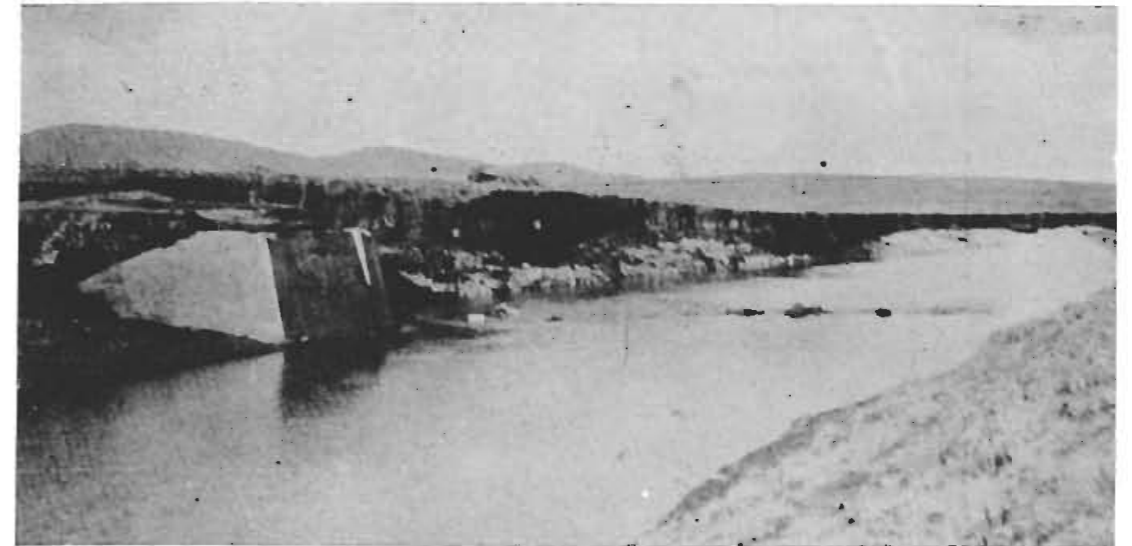
Figura 9. — El puente citado en figura 8 ha desaparecido por efectos de las aguas de la crecida de 1944.
