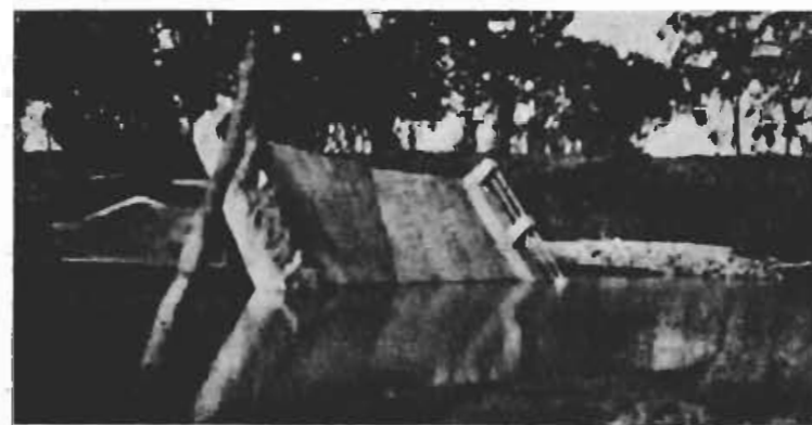
Figura 6. — Puente sobre el arroyo Corto destruido por la crecida de 1944.
